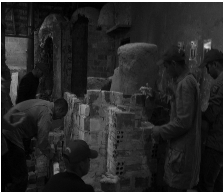
Construção do forno, colocação de tijolos refratários, parede interna e externa, construção da chaminé e reboque, tudo com a ajuda da escola de soldados (foto:Bastos)
